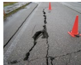
▲道路陥没の様子
